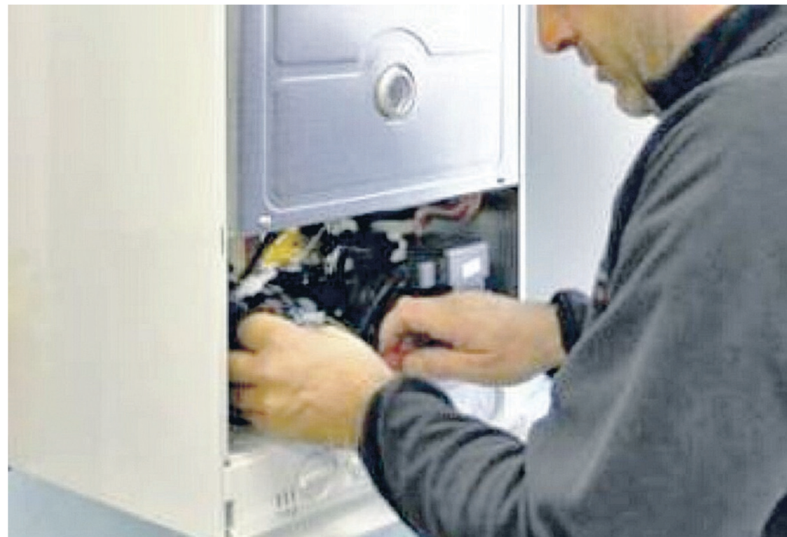
Un tecnico mentre effettua una manutenzione in una caldaia
